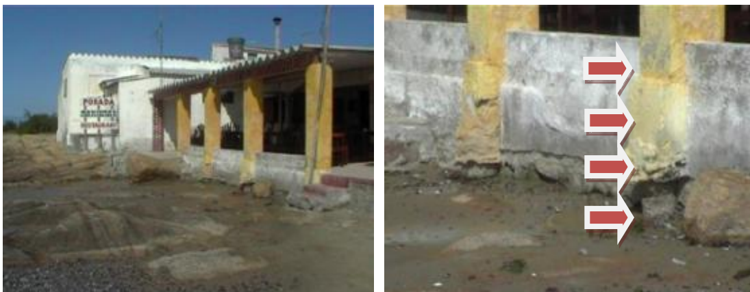
Fig. 121. Efecto de la erosión sufrida frente a las defensas de las construcciones ante el embate del oleaje. Nótese en detalle de imagen derecha el proceso de sucesivos descensos del nivel de la arena. (2007)
